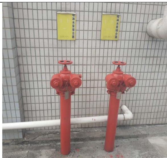
喷淋水管接合器
