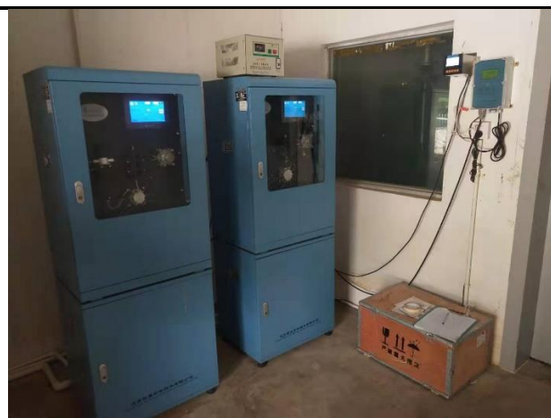
监测站房内部
